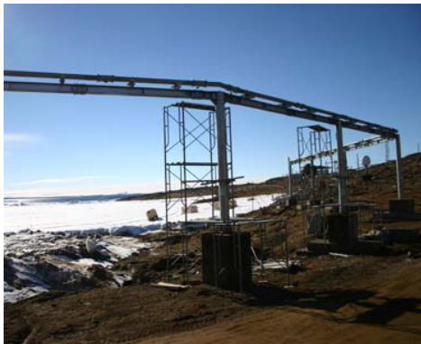
発電棟前的高架式パイプライン。頑強なコンクリート土台と柱はパイプラインの物々しさを語っている。都市圏の高架ハイウエーを思い出す。
